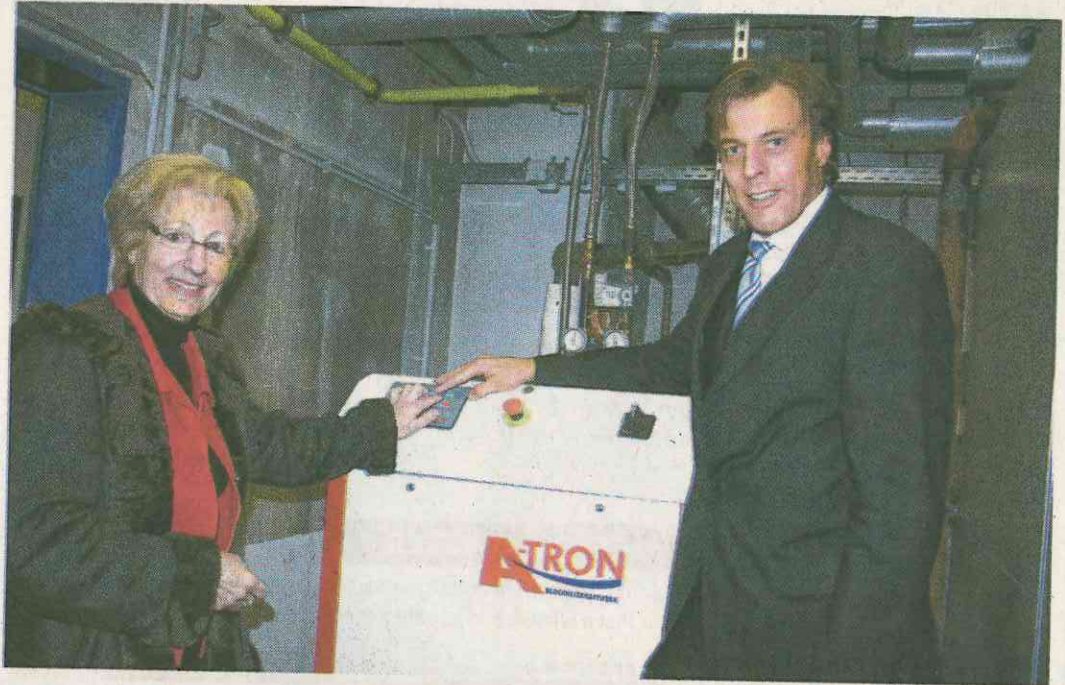
■ Hildegard Diekhans und Rainer Hegmann nahmen die hochmoderne Anlage in Betrieb, die Kosten und Kohlendioxid einsparen soll.
